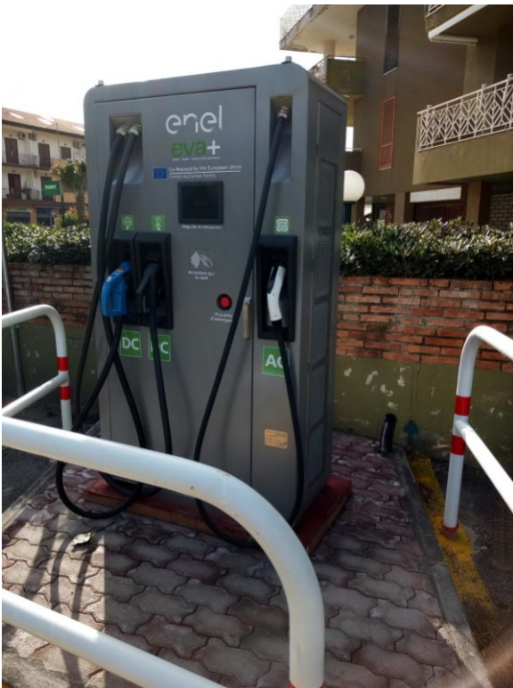
La colonnina Enel per la ricarica dei veicoli elettrici
